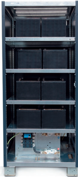
Armario de baterías
